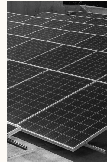
▲ Instalaciones de placas solares
