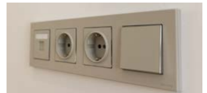
Electricidad y redes. Mecanismos compatibles con Domótica Niessen Sky o similar
